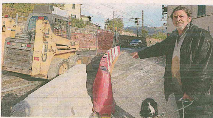
Per la realizzazione dei grandi cantieri lungo la via Aretina, il traffico in direzione di Pontassieve passa dentro l'abitato del Girone
